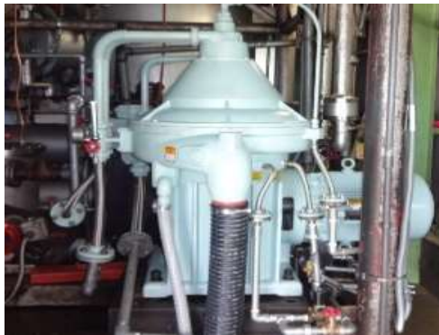
油水分離処理施設
