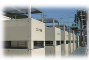
「バイオガス発電設備」
