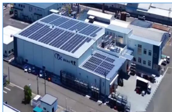
<当社工場屋根上太陽光設備の写真>
