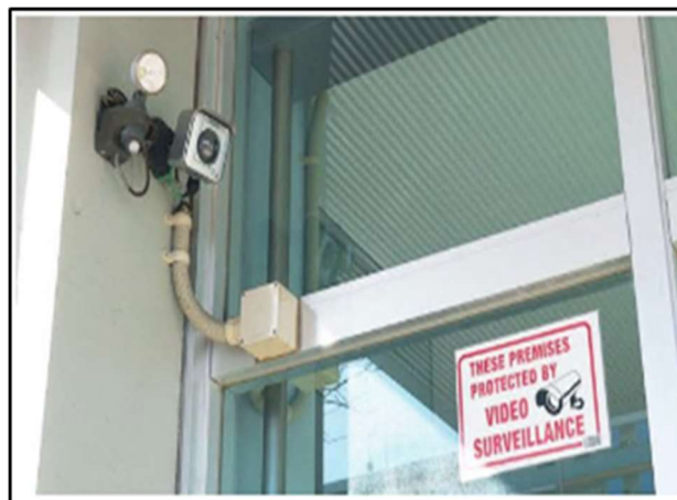
<工場入口・工場内に監視カメラ設置>
